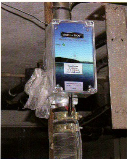
Vitaltron 2000 belebt das Wasser und wird auf die Hauptwasserleitung montiert.
